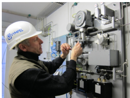
Рис. 1. Анализатор «Конг-Прима-10» на газопроводе «Северный поток» (Германия)
